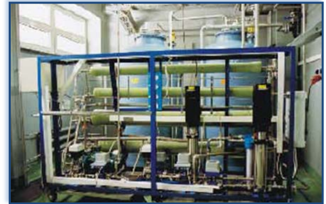
Instalacja wdrożona w ZUOP = UF+RO
